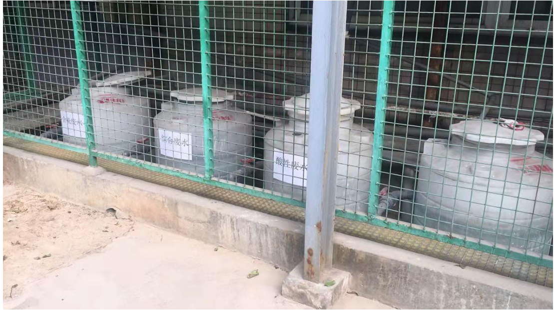
图 7.1-2 废水分类收集罐照片
