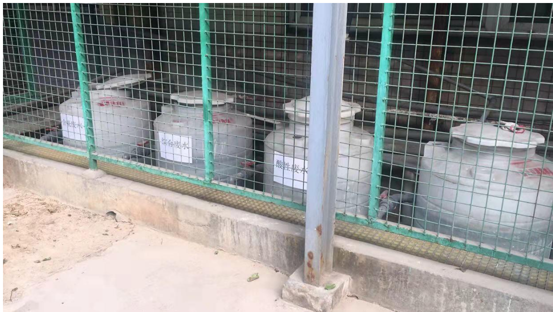
图 7.1-2 废水分类收集罐照片
